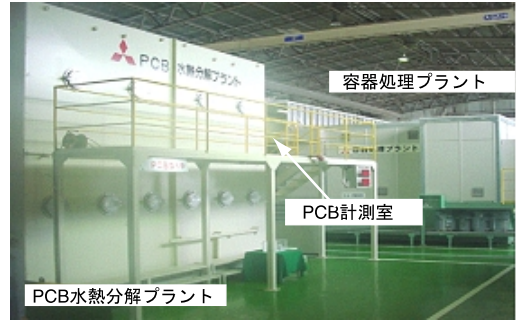
Fig.7 PCB 自家処理プラント写真
