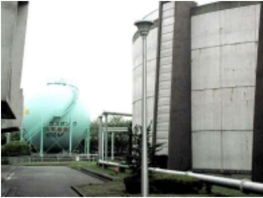
Fig.3 森ヶ崎水処理センター消化槽
