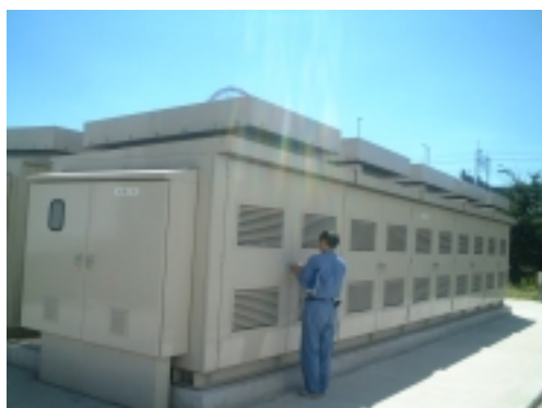
Fig.6 平成 13 年葛西処理場に導入した NAS 電池
