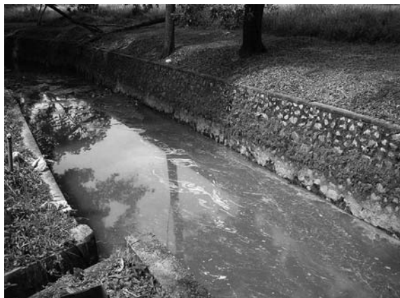
Photo 1 河川の水環境が悪化している例
