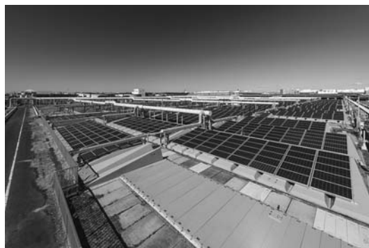
森ヶ崎水再生センター東施設の太陽光発電設備
