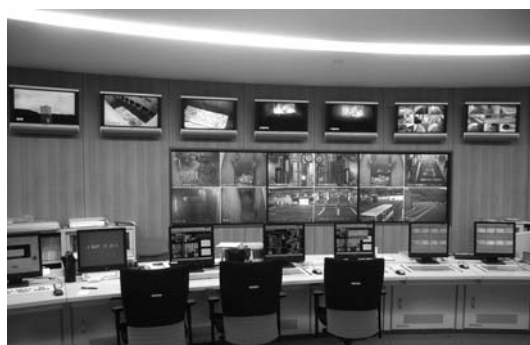
北部クリーンセンターの中央制御室
