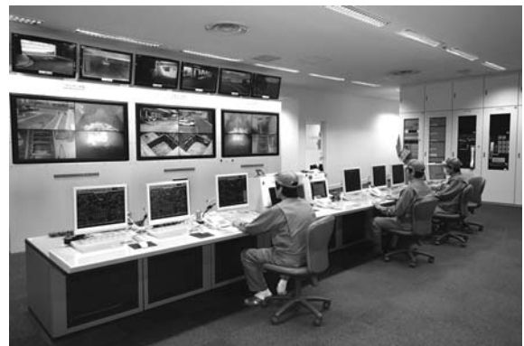
Photo 1 東淀工場中央制御室
