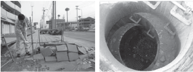
Photo 1 管路被災状況（左：液状化現象 マンホール躯体ずれ）
