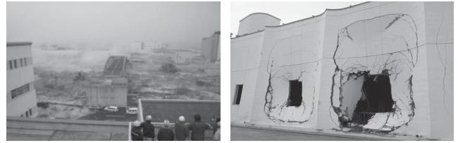
Photo 4 左：南蒲生浄化センターへの津波襲来 右：津波と瓦礫衝突で破壊した送風機棟
