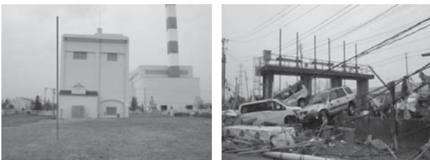
Photo 3 左：今泉雨水ポンプ場ポンプ棟の傾斜 右：西原排水ポンプ場流入ゲートの閉塞
