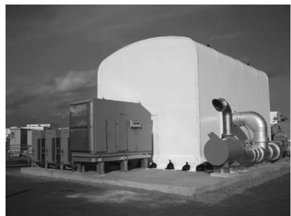
接触酸化フロア増設写真
