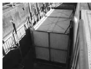
ひも状ろ材設置状況
