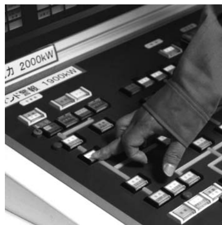
図1 水再生センターの監視操作盤
