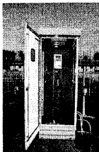
Fig 3 下水放流無試薬式残留塩素計 (屋外盤収納)
