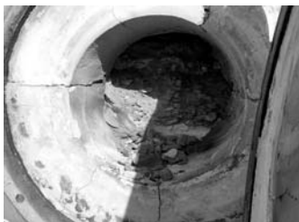
写真2 煙道内閉塞状況
