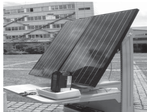
図8 太陽光発電パネルによる独立電源システム
