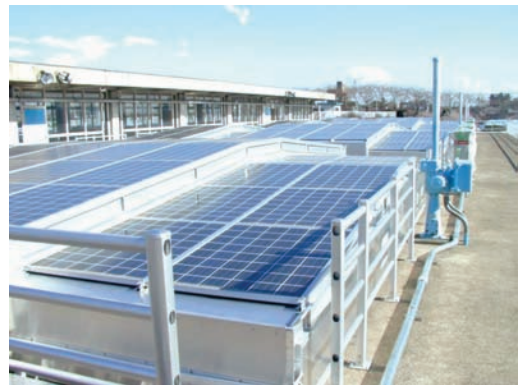
Fig.6 太陽光発電設備
