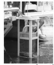
Fig.5 サンプリングポンプ設置状況
