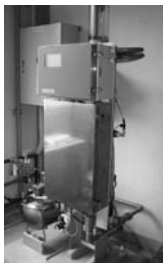
Fig.1 高感度油臭センサの屋内設置状況
